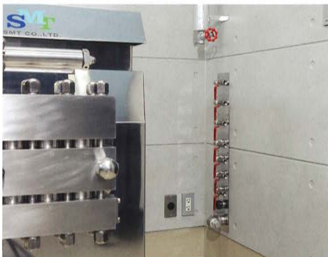
蒸気、温水、冷水、エア等、様々なユーティリティーを完備
